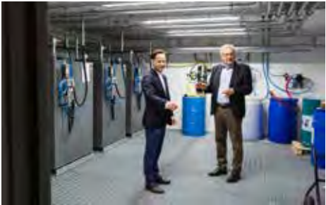
Alla oljor hanteras via ett sinnrikt system med ledningar från cisterner i källarplanet.
